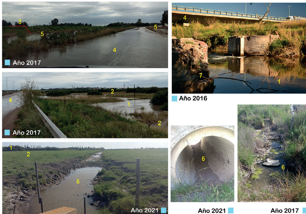
Figura 12. Afecciones antrópicas en tramo 4
